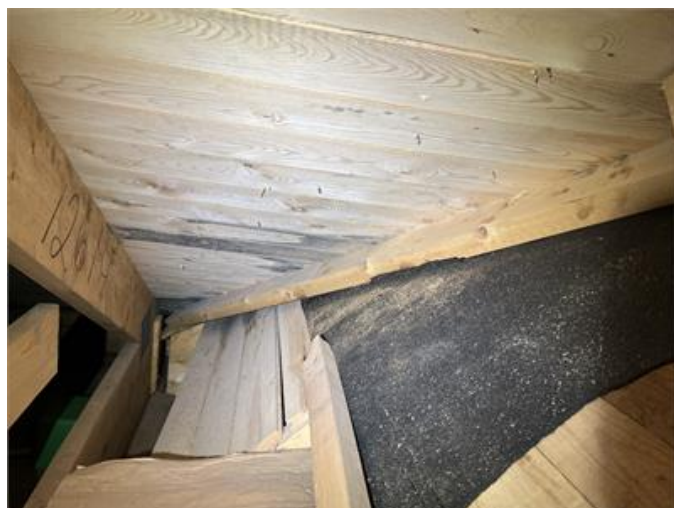
Lokala missfärgningar på garagevinden, hålls under uppsikt.
