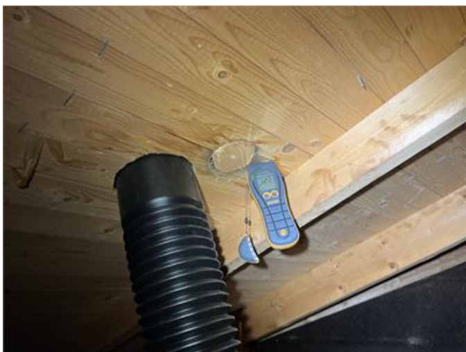
Fuktfäckor på vind över garage, inga förhöjda fuktvärden vid besiktningen.
