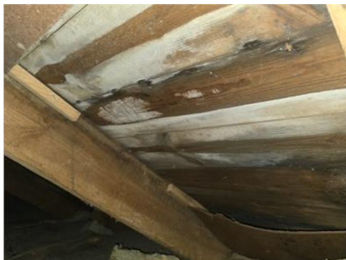
Mikrobiell påväxt/missfärgningar sidovind.
