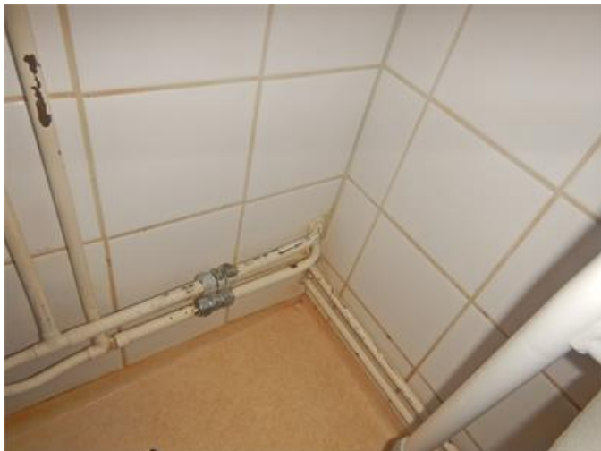
Rör genomföring i vägg i duschzon.
