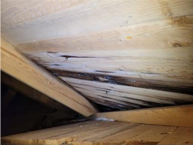
Läckage i yttertak
