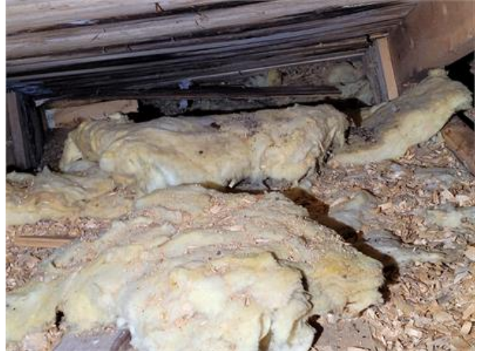
Läckage i yttertak
