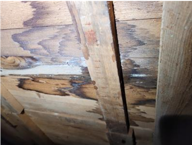
Läckage i trossbotten
