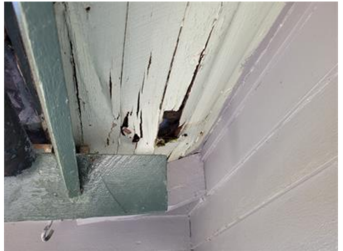
Rötskada i takfot
