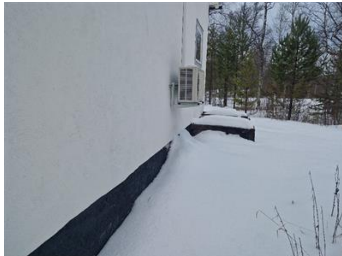
Kondensvatten leds ej bort från husgrund.
