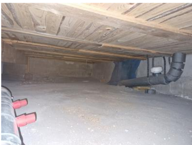
Del av grund saknar avdunstningsskydd.
