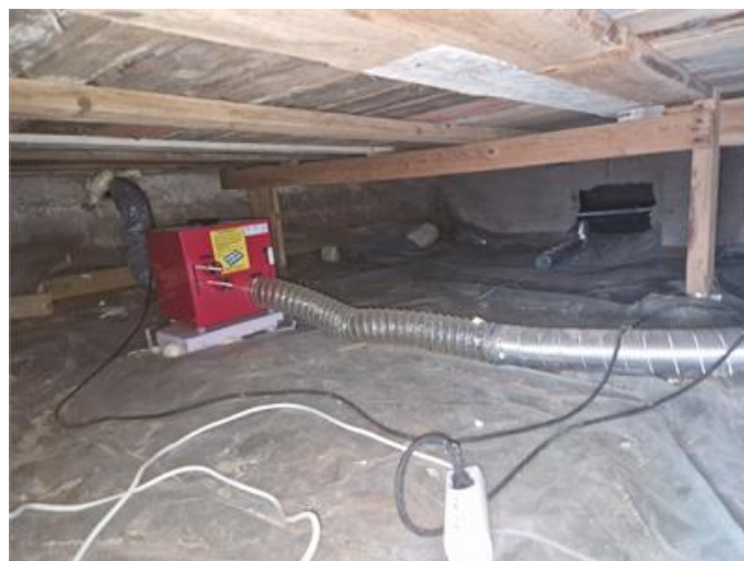
Krypgrundsavfuktare finns installerad i krypgrunden.
