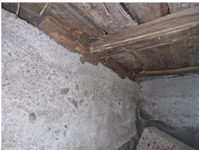
Krypgrund, röt och svampangrepp finns lämnad på trossbotten.
