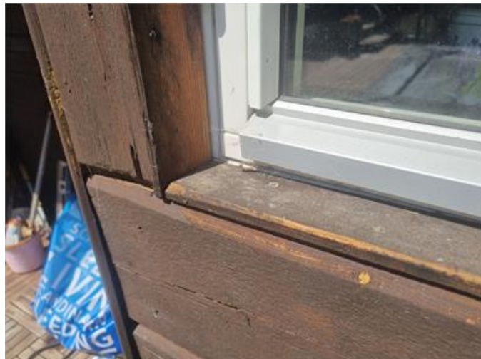
Exempelbild, avsaknad av fönsterbleck.
