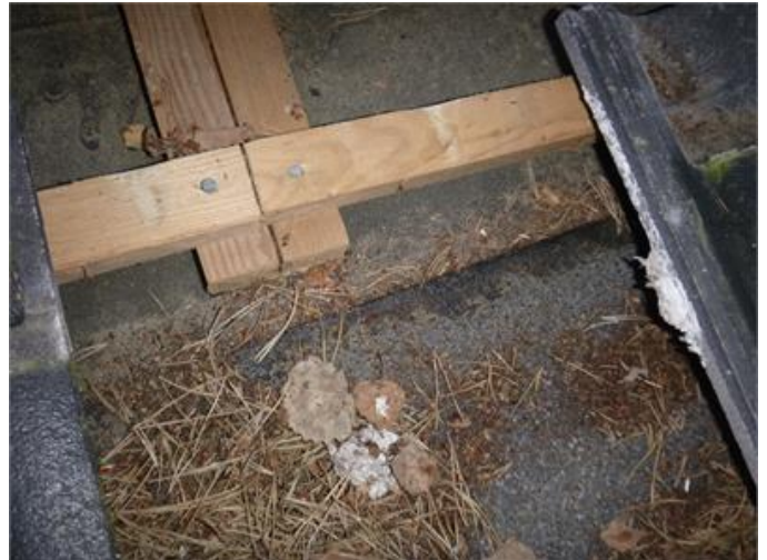
Bilden visar exempel på otätheter/brister i taktäckningen. (Ytpappen ovan badrum/tvättstuga som är ansluten ovan huvudbyggnadens underlagspapp).
