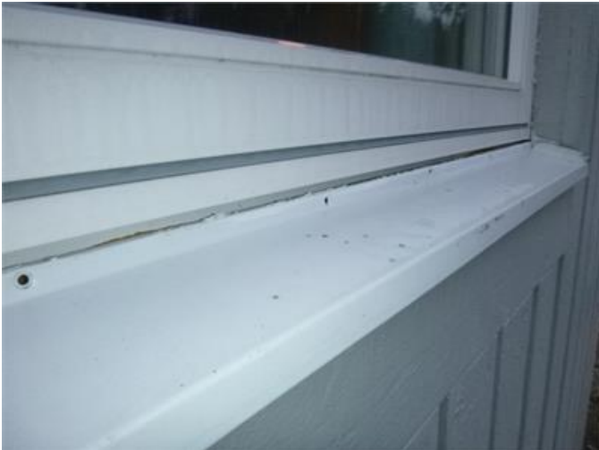
Bilden visar exempel på otätheter/brister vid/med plåtdetalj.
