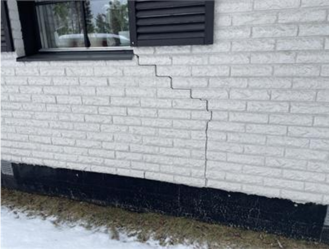
Sprickor förekommer i mexifasad.
