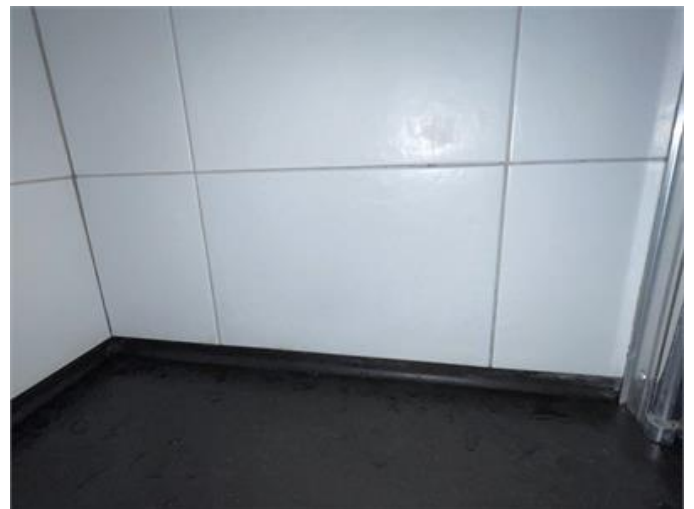
Spricka i fog kakel på vägg noteras i duschzon och lokalt något förhöjda fuktvärden uppmätta i dusch/WC.
