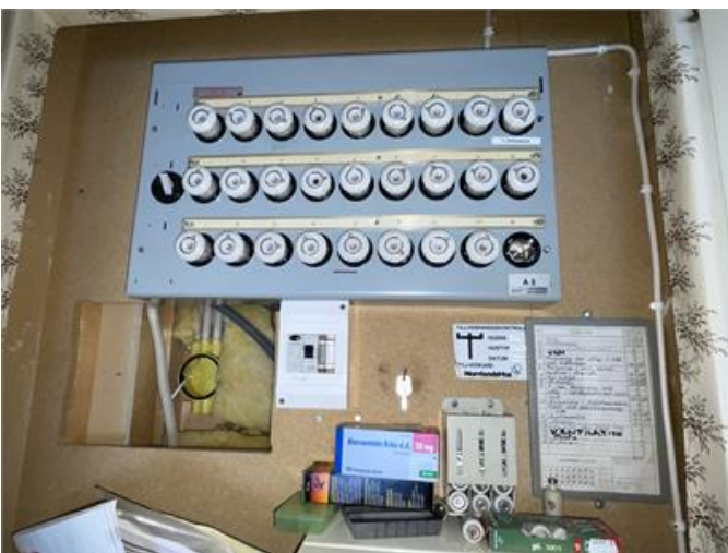
Elcentral är ej komplette, säkringshållare saknas.
