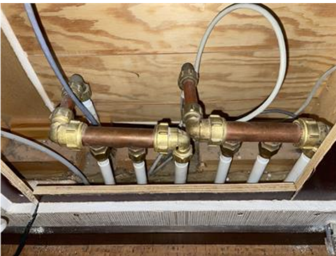
Kopplingsskåp saknas, kopplingar i vägg saknar omkringliggande fuktskydd.
