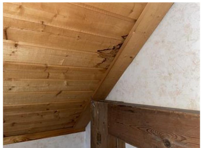
Fukt och rinningsmärken förekommer på tak allrum.
