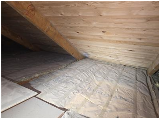
Exempel på lokal missfärgning mot takfot.
