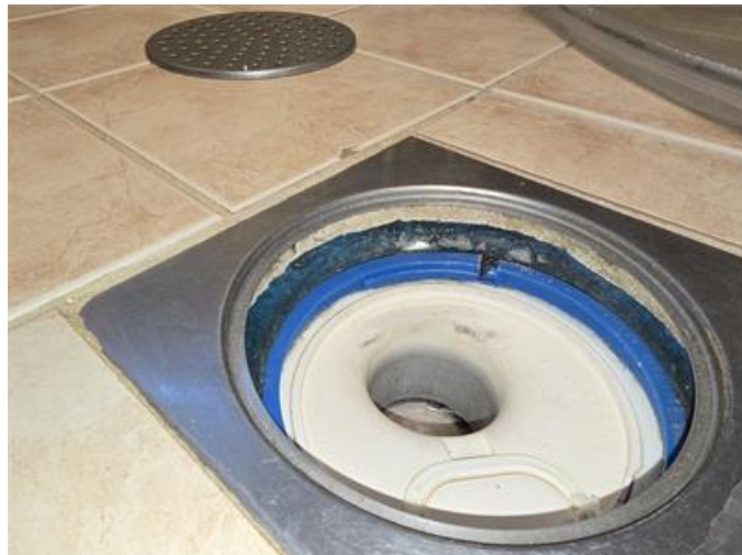
Brunnsmanschett på entréplan med skav/skada.
