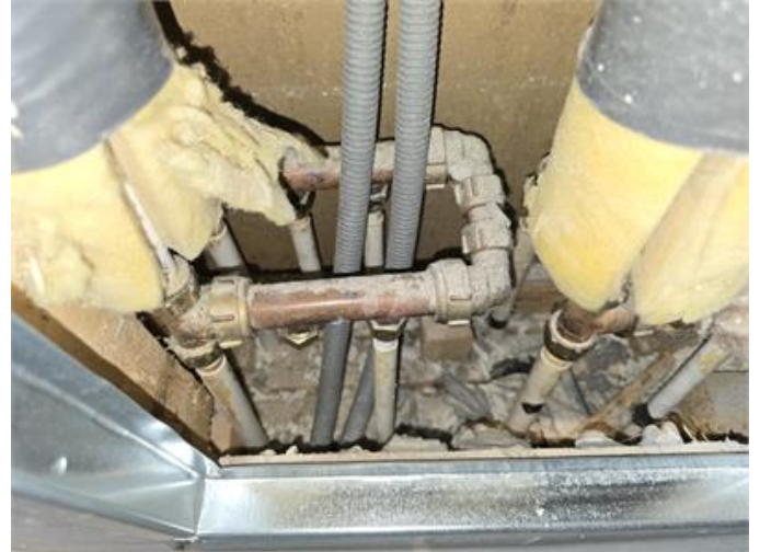
Vatteninstallationer i vägg dusch/wc.
