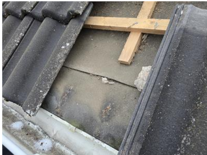
Pannor vilar på takpapp utan takfotsplåt.
