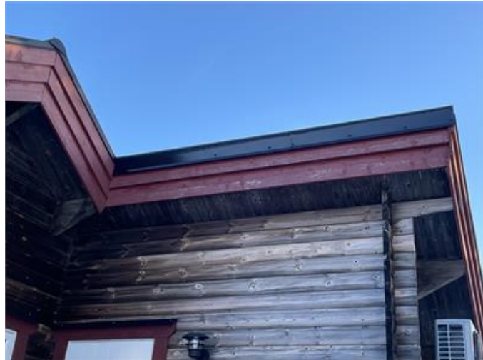
Trädetaljer på fasad och tak har lokalt målningsbehov.
