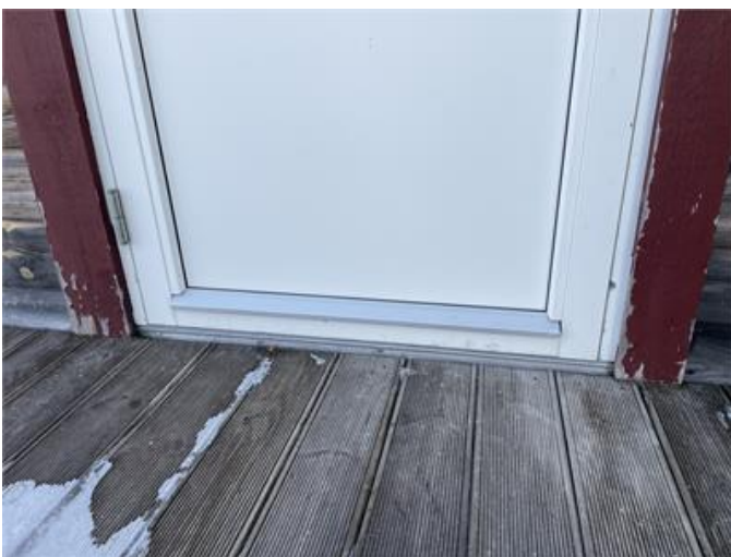
Tröskelbleck saknas på dörrar.
