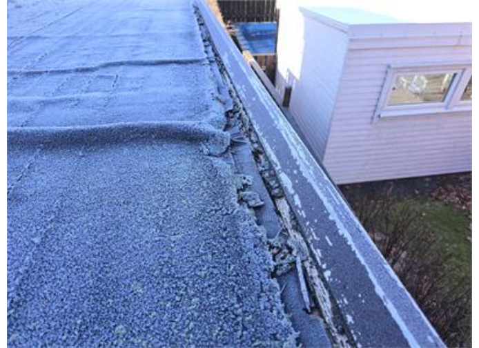
Garagetak med brister/reoveringsbehov.
