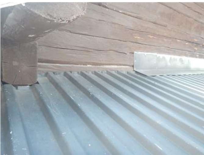
Plåt saknas delvis mellan husvägg/tak.
