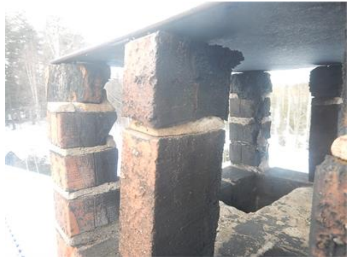
Överdel på skorstenen där stenar släppt/eroderat.
