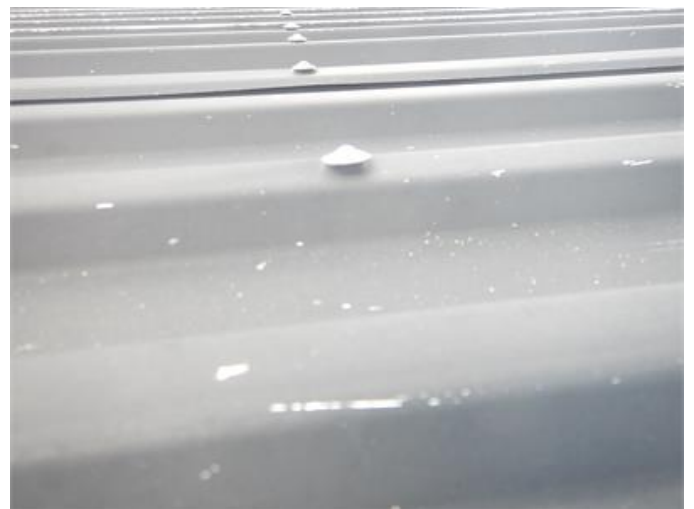
Plåtspik som krupit ur takplåt.
