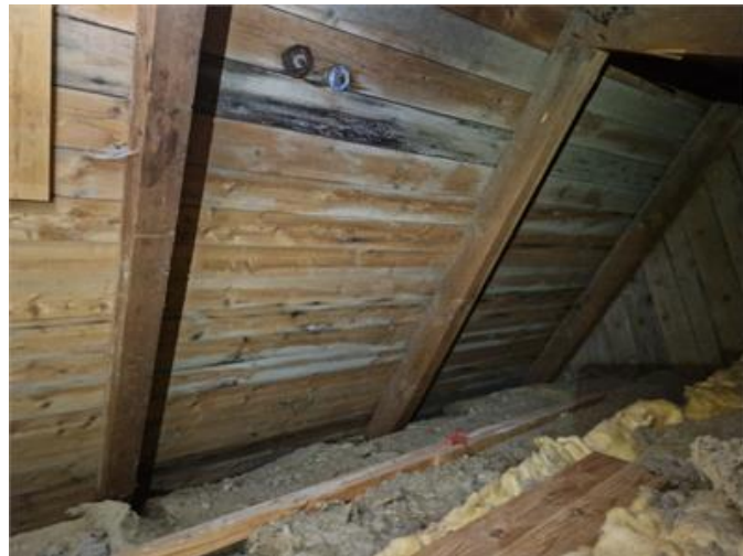
Vy på underlagstak med mikrobiell påväxt
