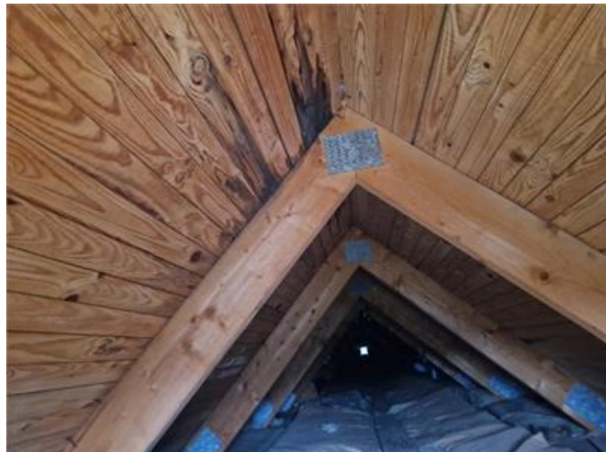
Vy på underlagstak med lokal missfärgning
