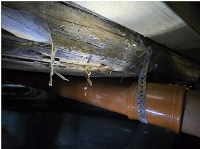
Ytliga rötskador på bärlina i krypgrund.
