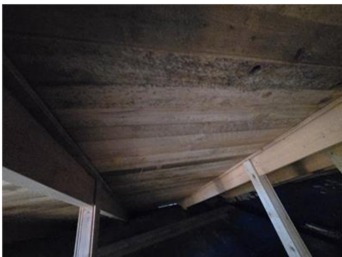
Mikrobiell påväxt på underlagstak.
