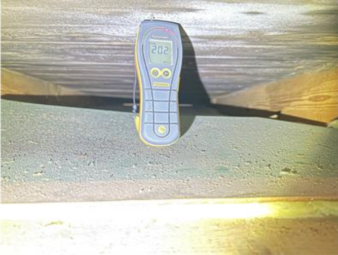
Mikrobiell påväxt på underlagstak och förhöjda fuktkvotsvärden, bilden visar takkupans underlagstak.
