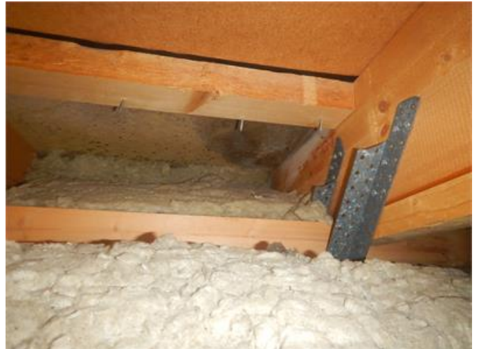
Mikrobiell påväxt på underlagstak vid ventilation.
