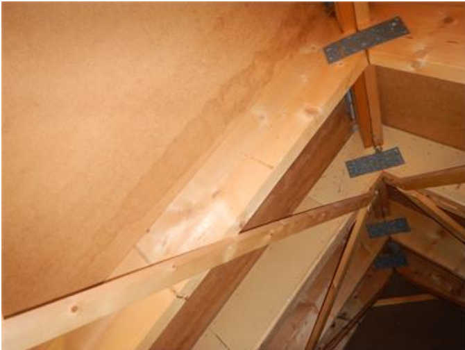
Fuktfläckar på underlagstak vind.
