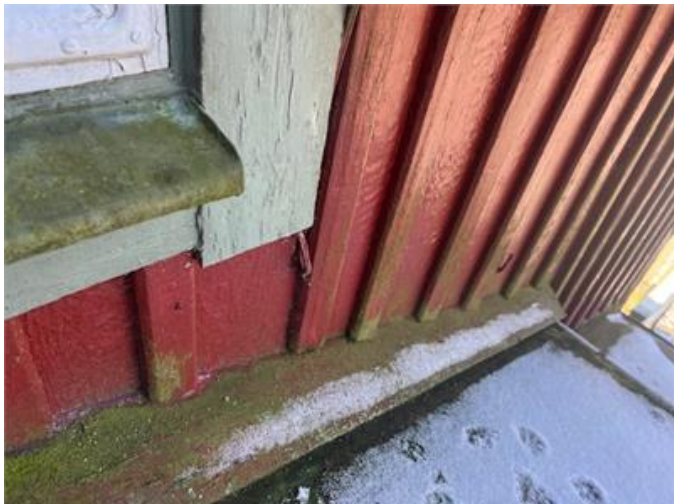
Pos 1. Fasadpanel ligger dikt an vissa plåtbeslag.
