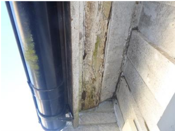
Läckage i garagetaket
