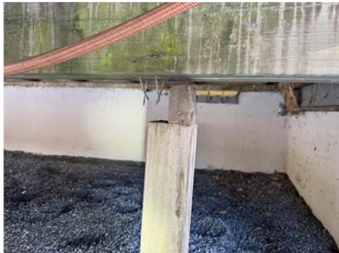
Altan saknar stöd mot en plint. Kan kompletteras med en klots eller liknande.
