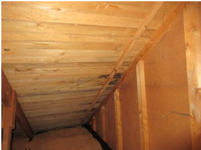
Fuktfläck på vind
