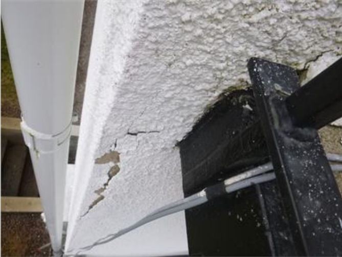
Bilden visar exempel på spricka/putssläpp i fasaden.
