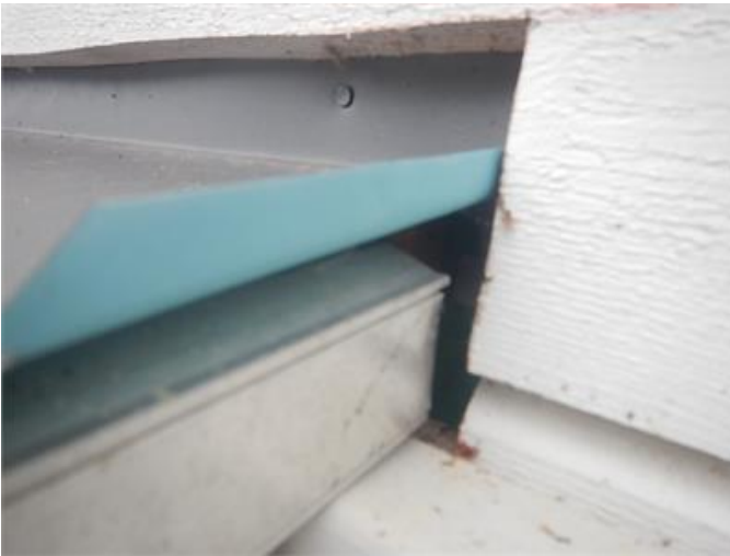
Otätthet i fasad vid plåt i överkant uterum.
