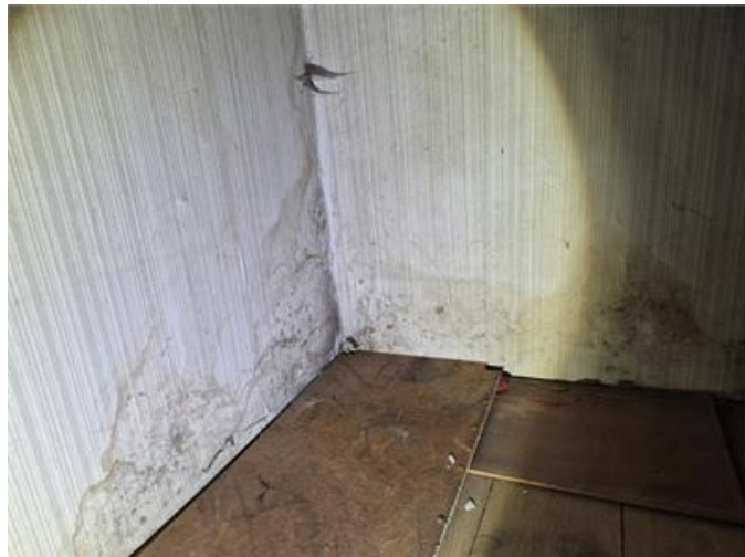
Bild på missfärgningarna vid nedgången till källaren.
