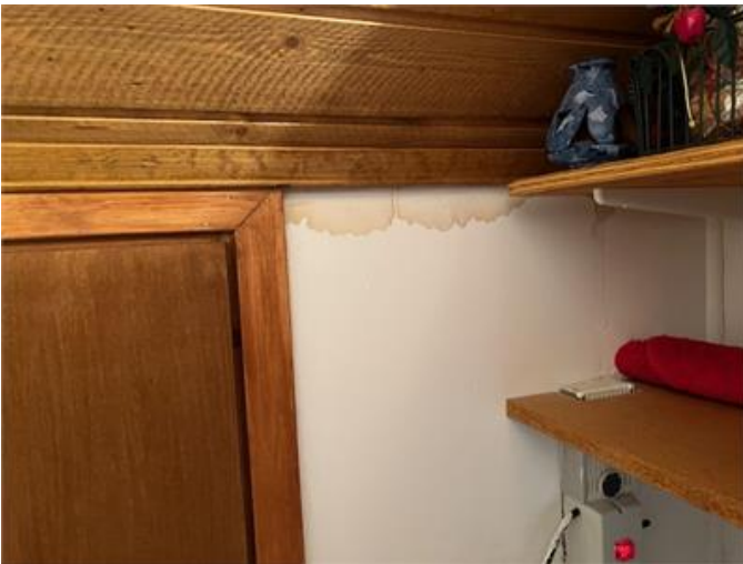
Pos 3. Fuktfläckar förekommer på vägg.
