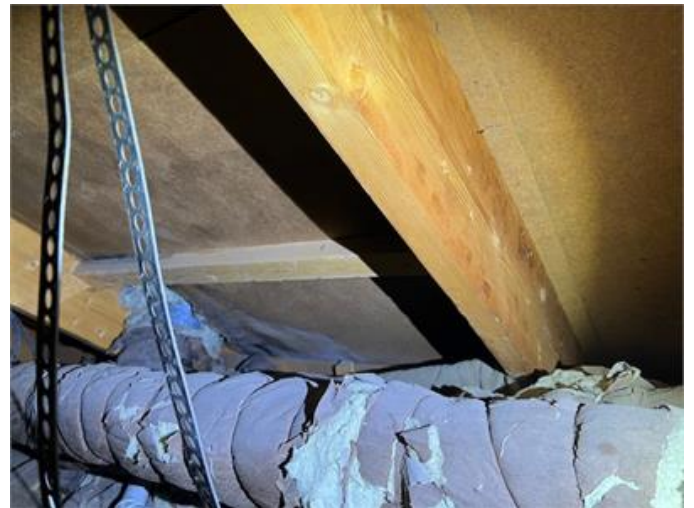
Pos 4. Fuktfläckar förekommer på underlagstak.
