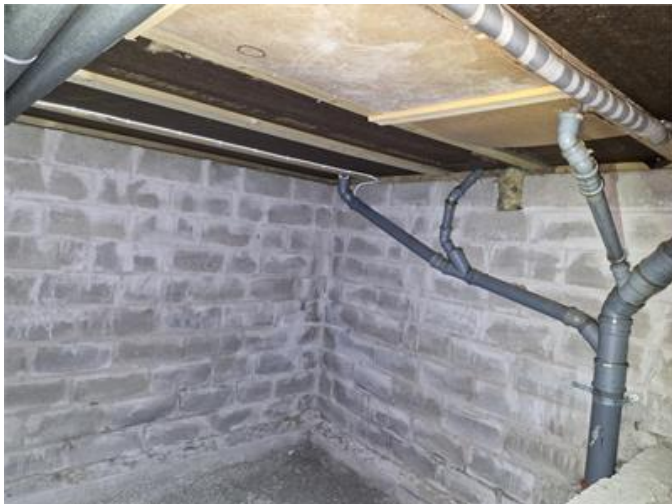
Krypgrund under utbyggnad, översiktsbild, missfärgning på utbytt blindbottenskiva.
