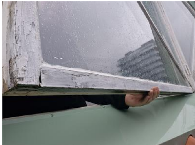
Fönster, underhållsbehov av äldre fönster, bild från bågfenster loft
