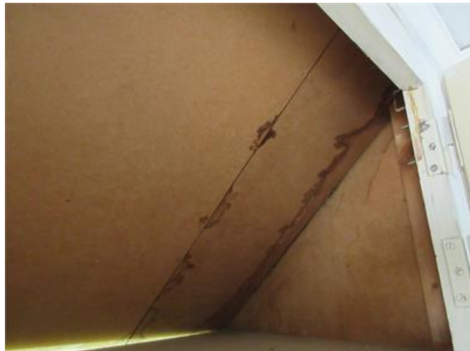
Missfärgningar i tak garderob som 3
