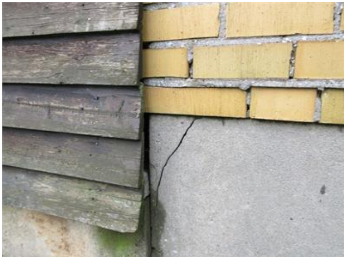
Sprickor i sockel och fogsläpp i tegelfasad
