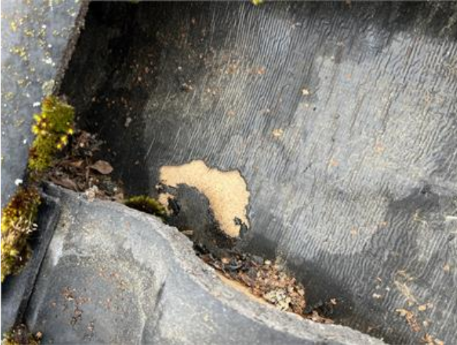
Lokal skada i underlagsduk under takpannor.
