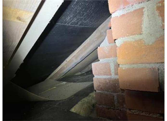
Luftspaltsskiva på kallvinden som släppt från infästning.
