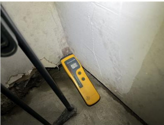
Fuktgenomslag källaryttervägg där förhöjda fuktvärden uppmättes.
