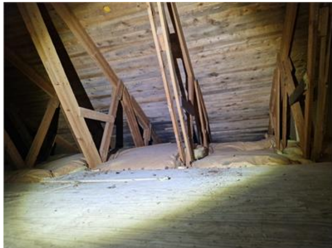
Vy på vindsutrymmet med missfärgning på underlagstak
