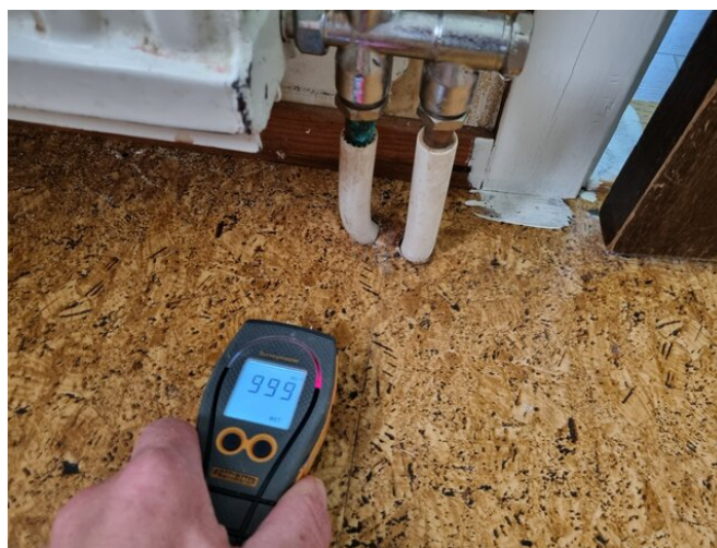
Förhöjd fukt indikeras över golvet intill radiator
