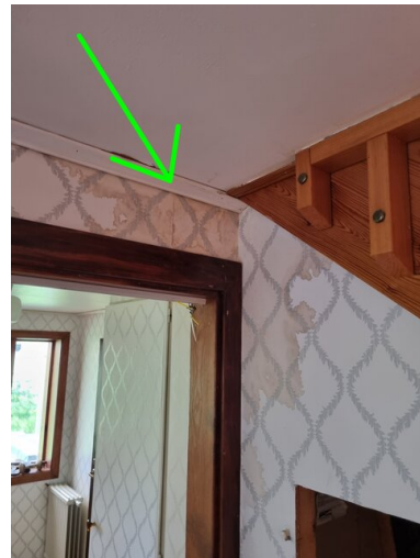
Fuktskador i överkant vägg
