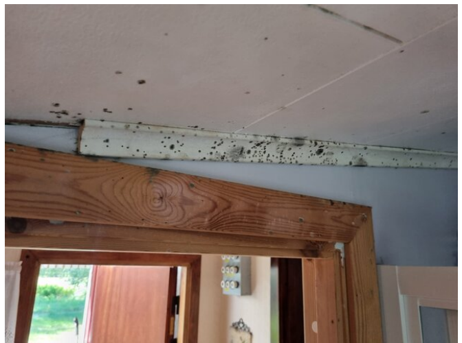
Översikt, fukt och mögelskador
