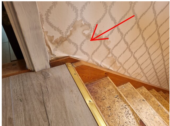
Fuktskador på tapet/vägg
