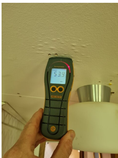
Hög fukt i innertaket
