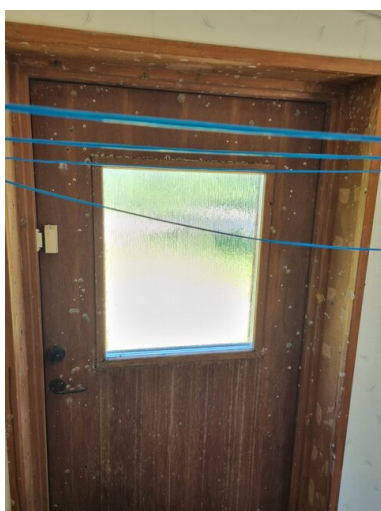
Fukt och mögelskador vid dörr/dörrsmyg
