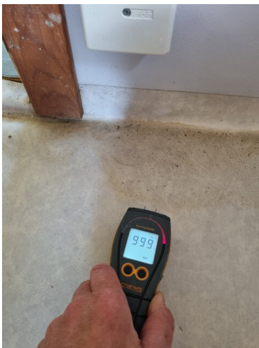
Hög fukt indikeras över golvet
