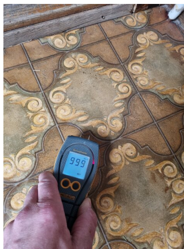
Hög fukt indikeras över golvet
