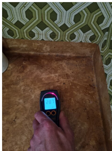
Förhöjd fukt indikeras över golvet
