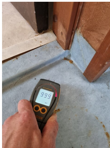
Hög fukt indikeras över golvet
