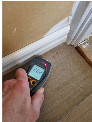
Förhöjda fuktindikationer över golvet.
