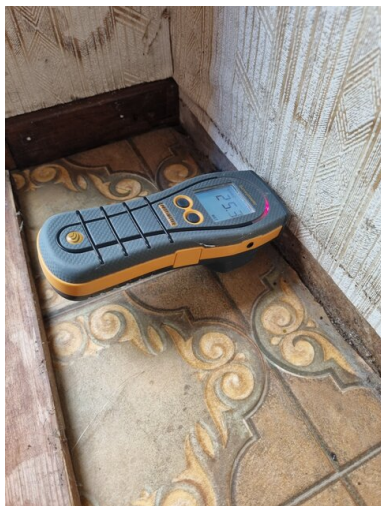
Hög fukt i nederkant vägg
