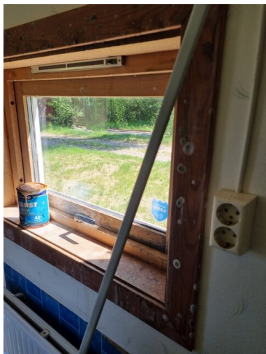
Fukt och mögelskador
