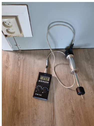
Förhöjd fukt i väggen
