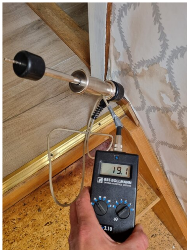
Förhöjd fukt i väggen.
