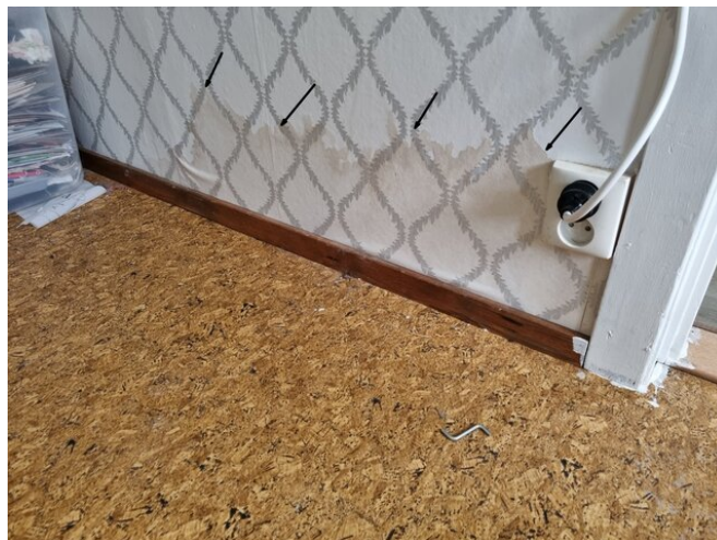
Fuktskador i nederkant innervägg
