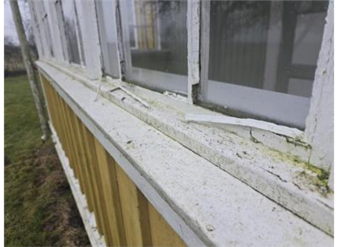
Exempelbild, målning/underhållsbehov fönster.
