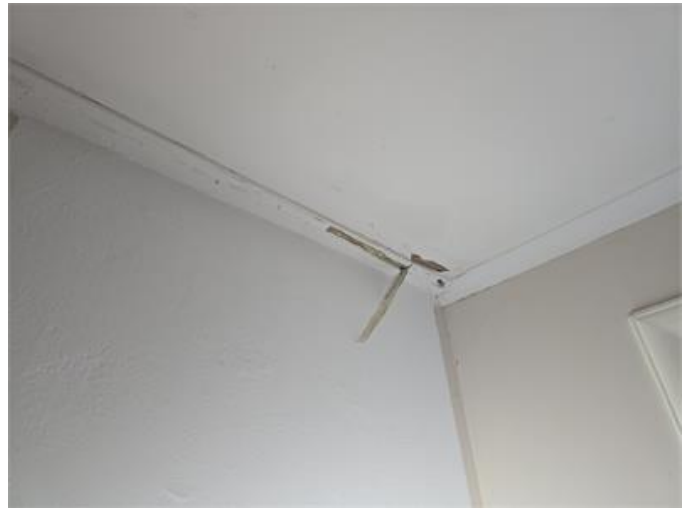
Fuktpåverkan innertak intill murstock, hall, övre plan.
