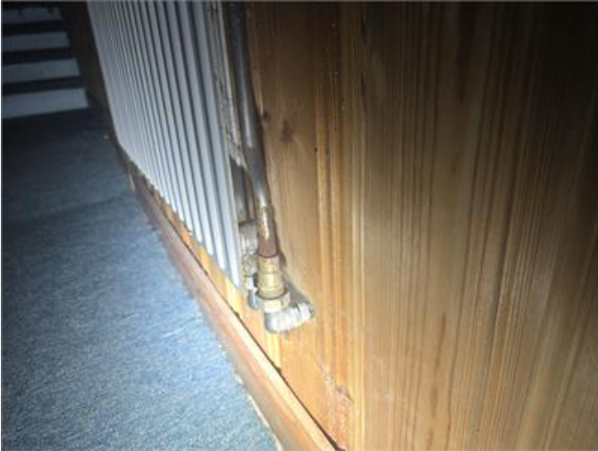
Exempelbild, rostangrepp värmerör/koppling.
