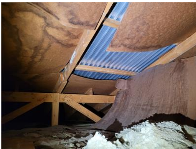
Åtgärdsbehov på vinden.
