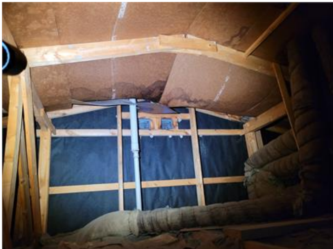
Åtgärdsbehov på vinden.
