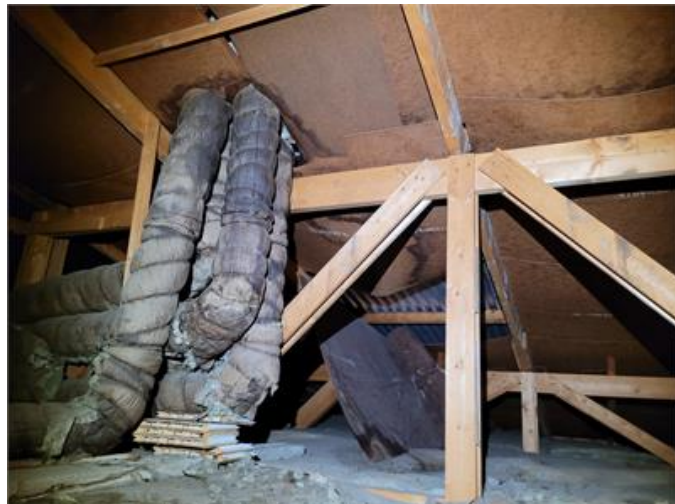
Åtgärdsbehov på vinden.
