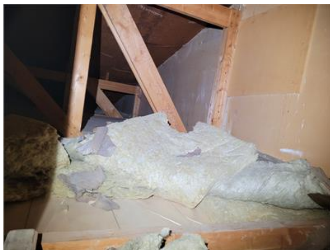
Åtgärdsbehov på vinden.
