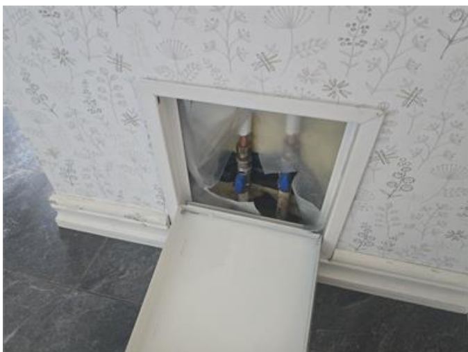
Kopplingsskåp i entréhall, entréplan.
