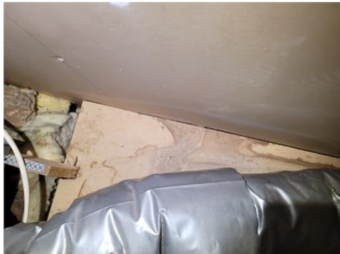
Fuktfläck på landgång
