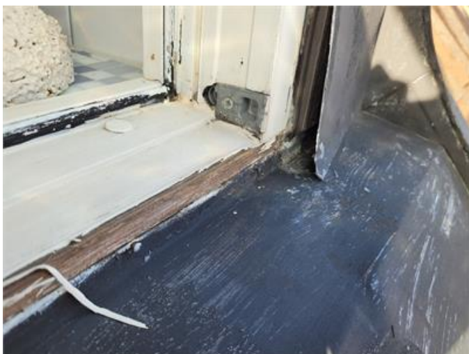
Fönster med underhållsbehov samt plåt som ej tätar mot karm.
