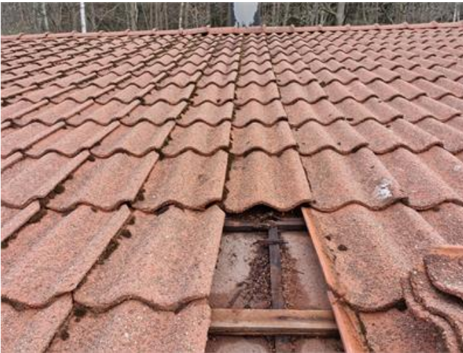
Tak, fuktskador förekommer i ursprungliga delen.
