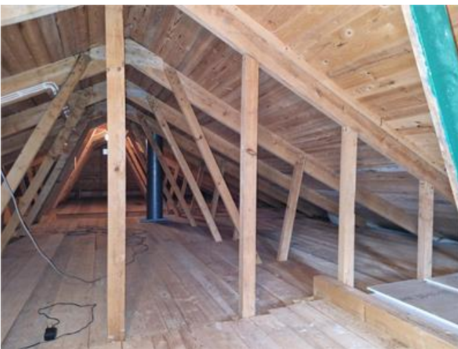
Nockvind, översiktsbild ursprunglig del.
