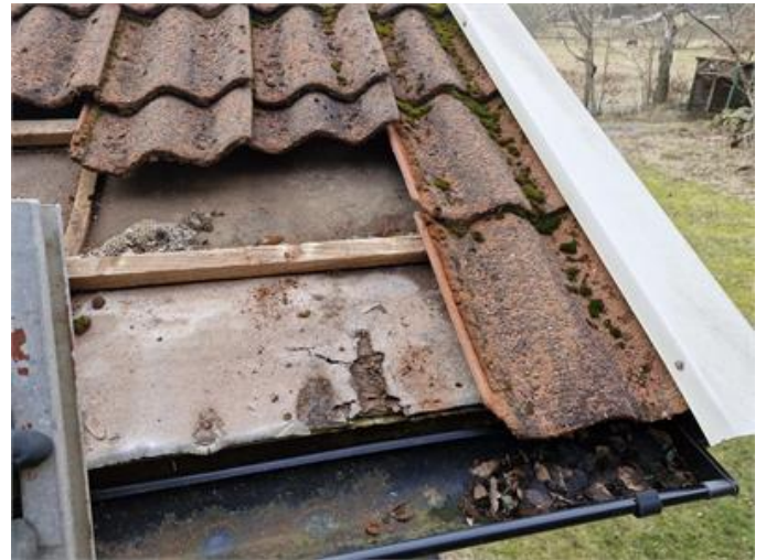
Tak, fuktskador förekommer i ursprungliga delen.
