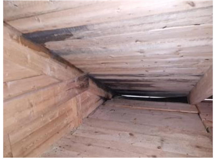
Nockvind, missfärgningar/mikrobiell påväxt nordöstra hörnet.
