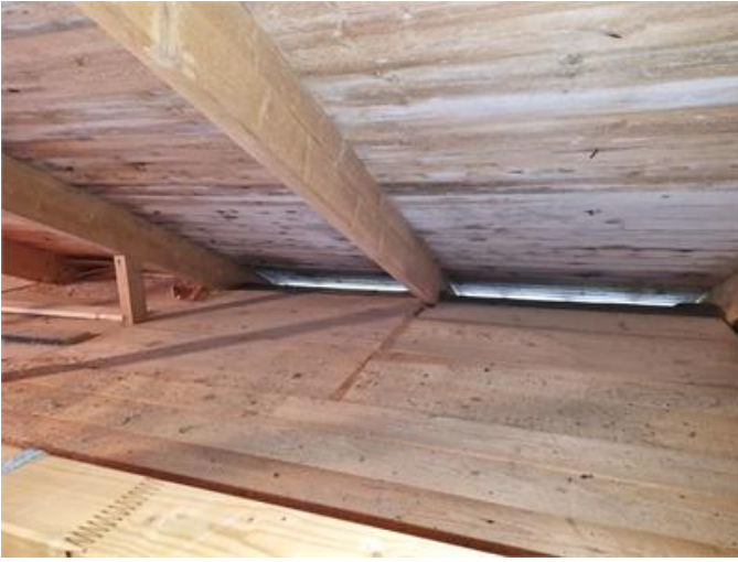
Nockvind, missfärgningar/mikrobiell påväxt mittre delen söder.
