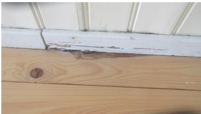
Blöt fuktfläck på golvet i det inredda uterummet.
