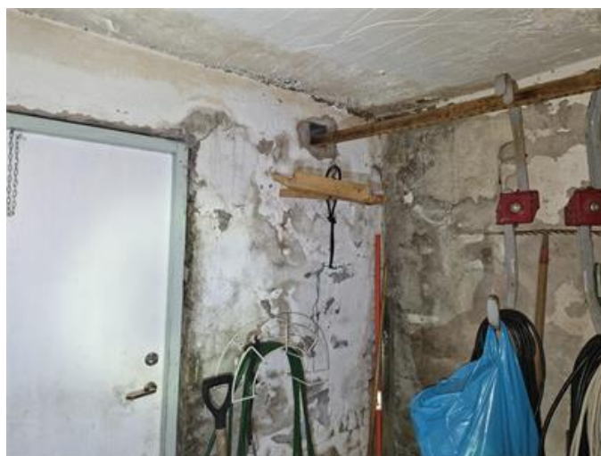
Förråd, fuktgenomslag under balkong.
