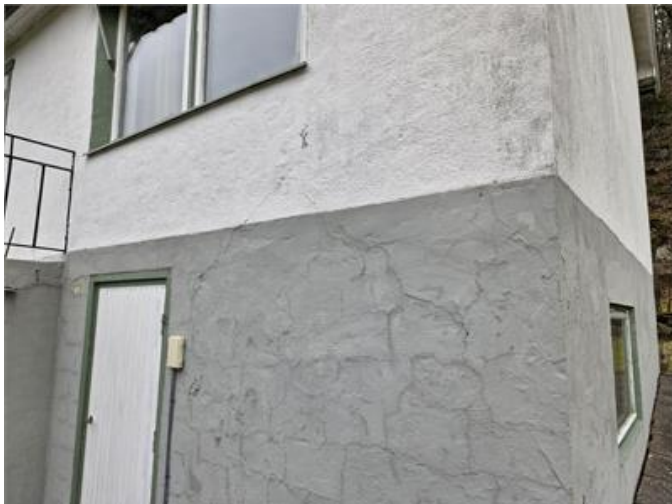
Fasad och Sockel, sprickor och krackelingar i putsen förekommer.
