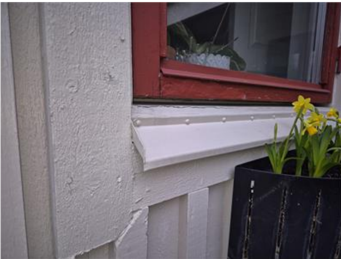
Fönsterparti med rötskada.
