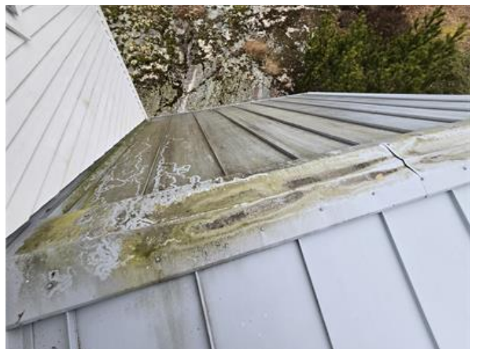
Tak: Alg/moss påväxt mot norr.
