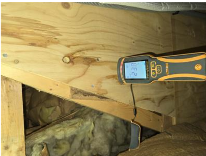
Nockvind: Fuktanvisning på träfiberskiva.
