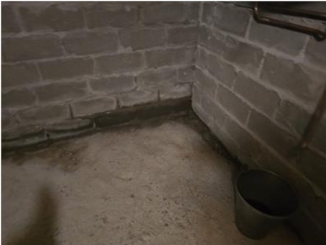
Grovkällare: Fuktanvisning nederkant grundmur.
