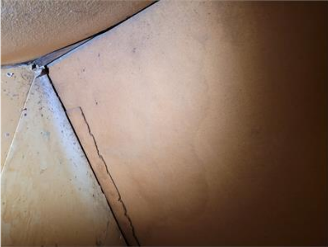
Fuktfläckar på underlagstak
