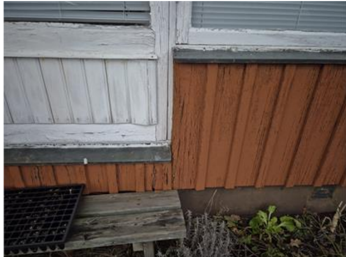
Torrspäckor/skador i altandörr och panel.
