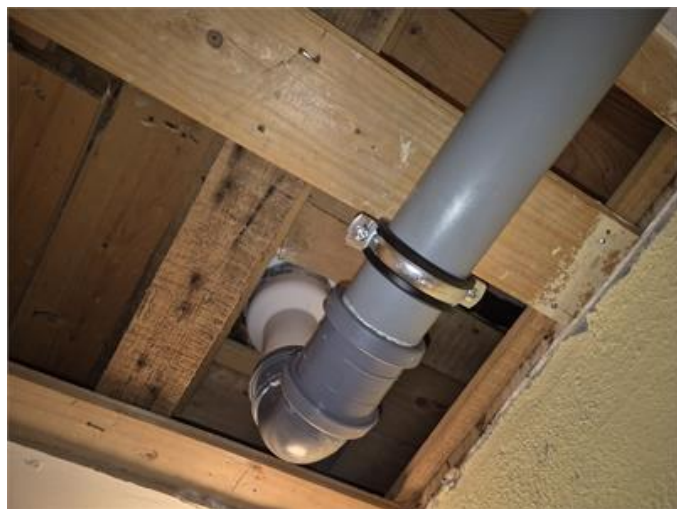
På grund av läckage har bjälklag under badrum frilagts och konstaterat spår efter läckage intill golvsbrunn.
