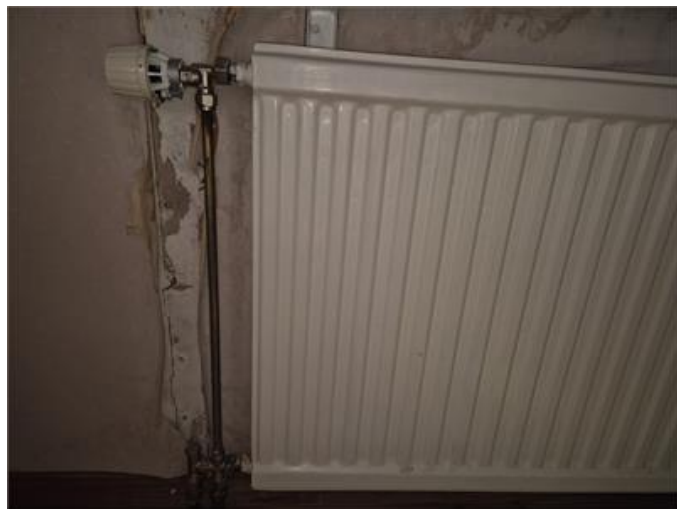
Fuktskada i yttervägg.
