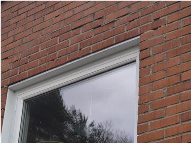
Fogsläpp och skadade fasadstenar.
