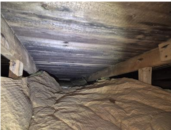
Missfärgningar/mikrobiella tillväxter på vind.
