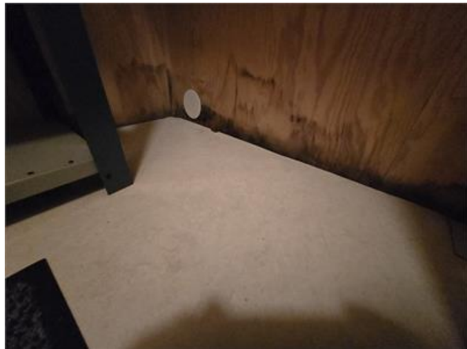
Källare: Fuktfläckar/missfärgning på träskivor.
