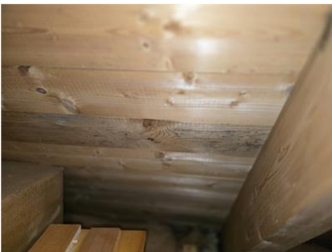
Nockvind: Mindre mikrobiell påväxt på underlagstak.
