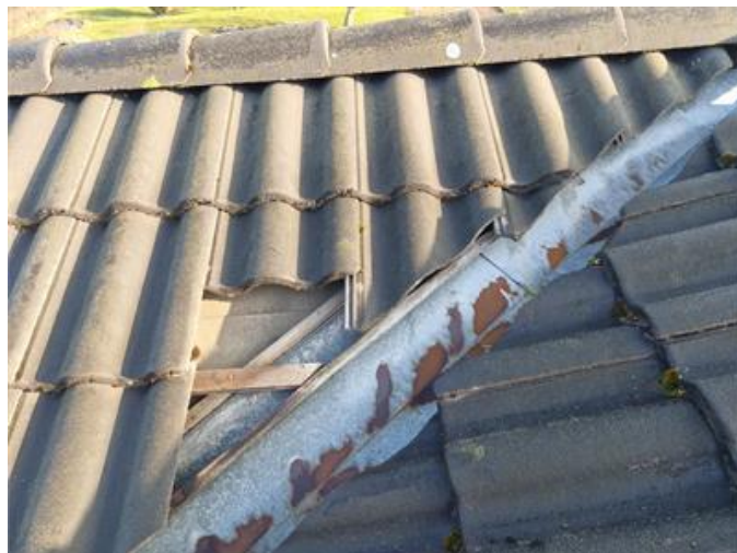
Tak, läkt i rännedal fuktskadad.
