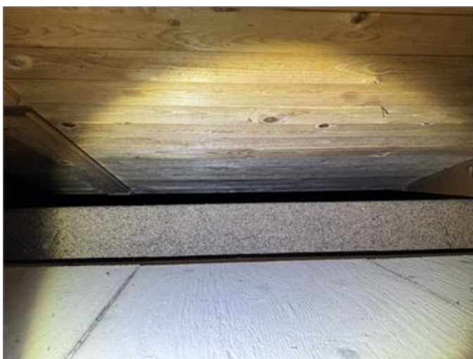
Mikrobiell påväxt i begränsad omfattning utmed takfoten på framsidan.
