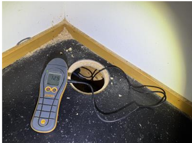
Fuktkvotsmätning i matkällarens uppreglade golv.
