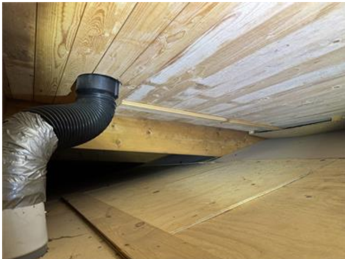
Mindre mängd mikrobiell påväxt på vindens underlagstak.
