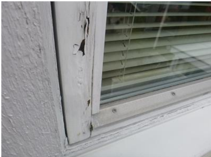
Bilden visar rötskadat fönster.
