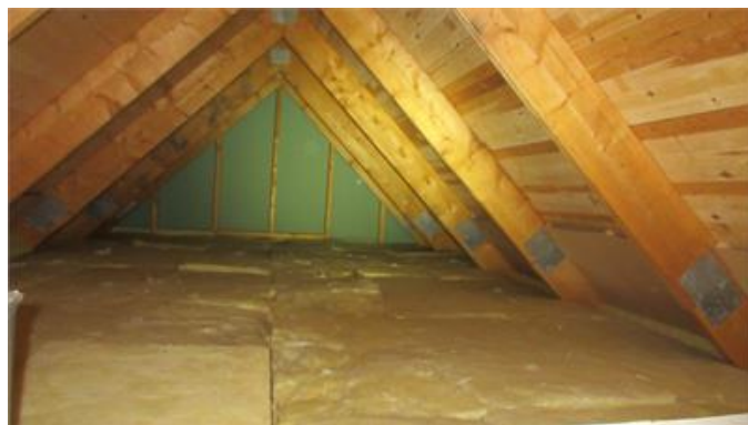
Mikrobiell påväxt pånockvindens underlagstak.
