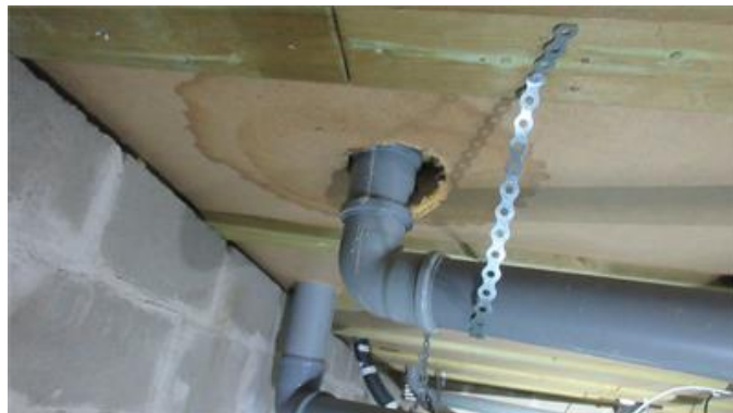
Missfärgning blindbotten i krypgrund.
