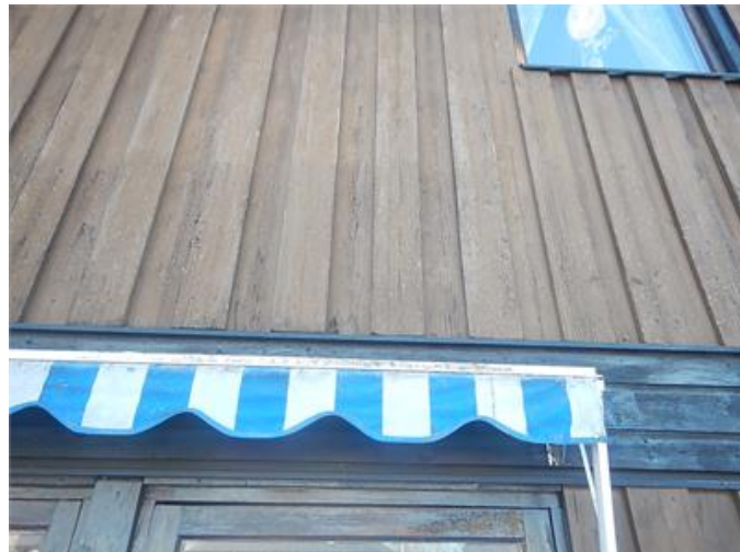
Fasadpanel med underhållsbehov/mindre rötskador.
