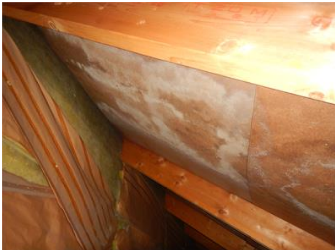
Fuktpåverkan på underlagstak sidovind lokalt vid takfönster.
