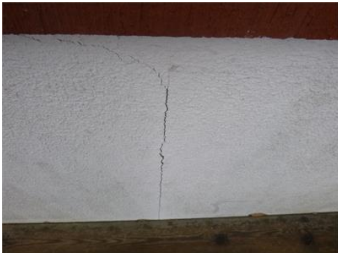
Bilden visar exempel på spricka i sockeln.
